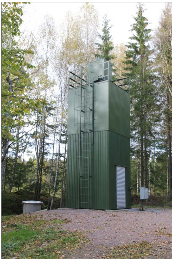
Nyrenoverad kalkdosererare vid Åbogen som ersatt den tidigare av rund modell. Foto: Myrica.
